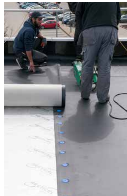
De EPDM-dakbanen worden gesteld met overlappen van 110 mm, de bevestigers worden op ruime afstand van de baanrand geplaatst.
