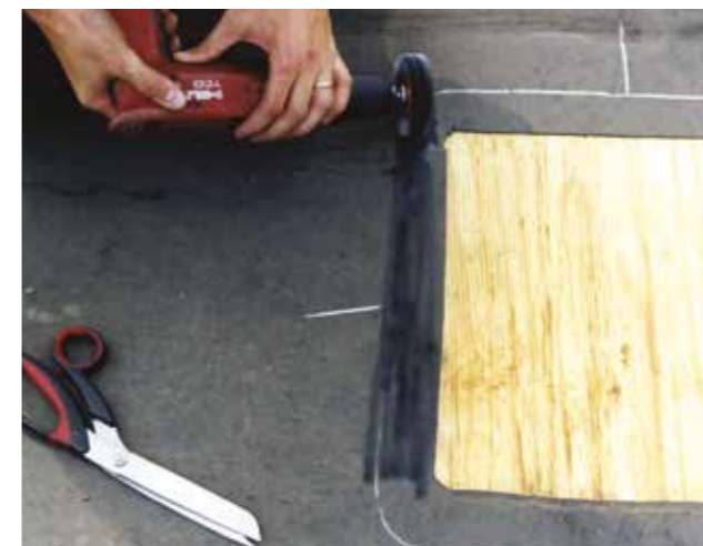
Het door het uitgesneden monster ontstane gat wordt gerepareerd. Voor de kwaliteit van de overlapverbinding wordt de oude EPDM-dakbedekking opgeruwd.
