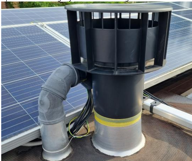
Figuur 10: Voorbeeld van een uitlaatpijp die te dicht op de panelen is geplaatst en daardoor de bypass diode langdurig in geleiding zet met warmteontwikkeling tot gevolg.
